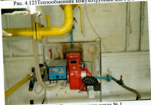
Рис. 4.125 Газовая горелка котла № 1
