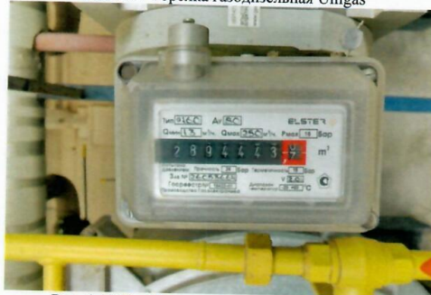
Рис. 4.19 Прибор учета расхода газа котла № 1
