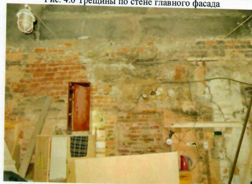
Рис. 4.8 Разрушение кирпичной кладки несущей стены
