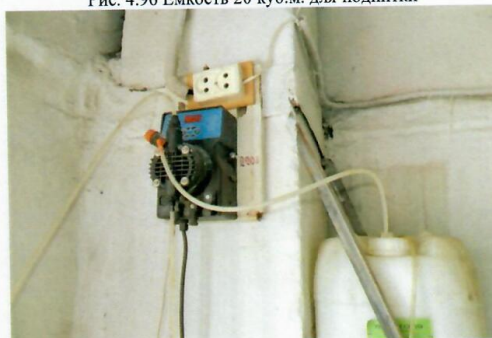
Рис. 4.98 Дозатор хим.водоподготовки с канистрой реагентов СК-110
