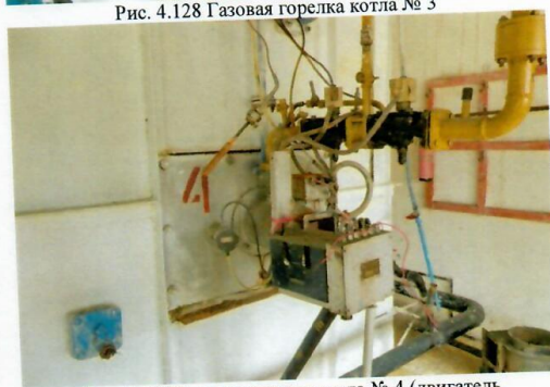
Рис. 4.130 Газовая горелка котла № 4 (двигатель демонтирован)
