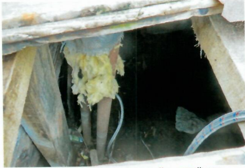
Рис. 4.101 Колодец магистральный тепловой сети
