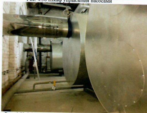
Рис. 4.58 Общий вид котлов сзади (КВ-ГМ-3-115 -3шт)
