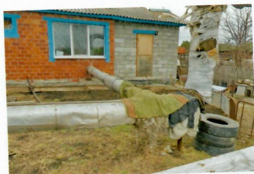
Рис. 4.137 Ввод в жилой дом. Разрушение теплоизоляции
