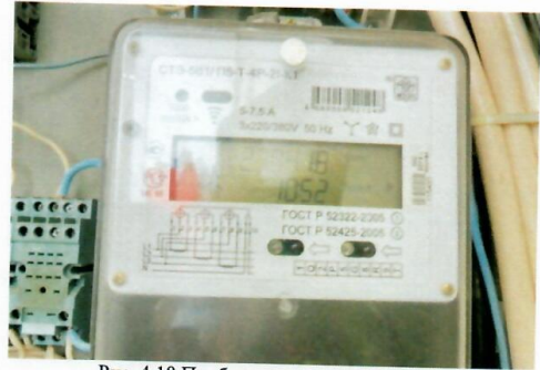
Рис. 4.18 Прибор учета электроэнергии
