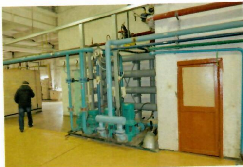
Рис. 4.93 Насосное оборудование котельной
