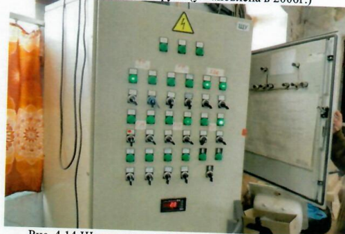
Рис. 4.14 Щит управления насосами и вентиляторами
