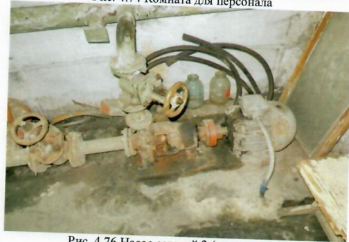
Рис. 4.76 Насос сетевой 2 (неисправен)
