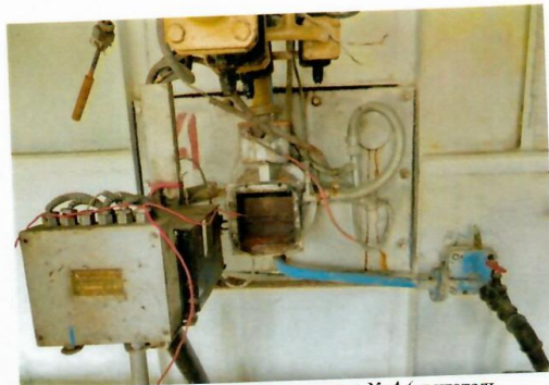
Рис. 4.132 Газовая горелка котла № 4 (двигатель демонтирован)
