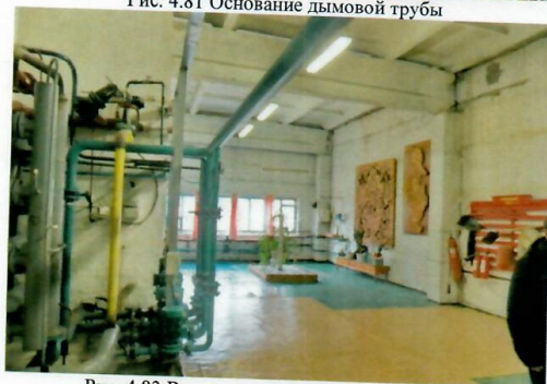
Рис. 4.83 Внутреннее помещение котельной
