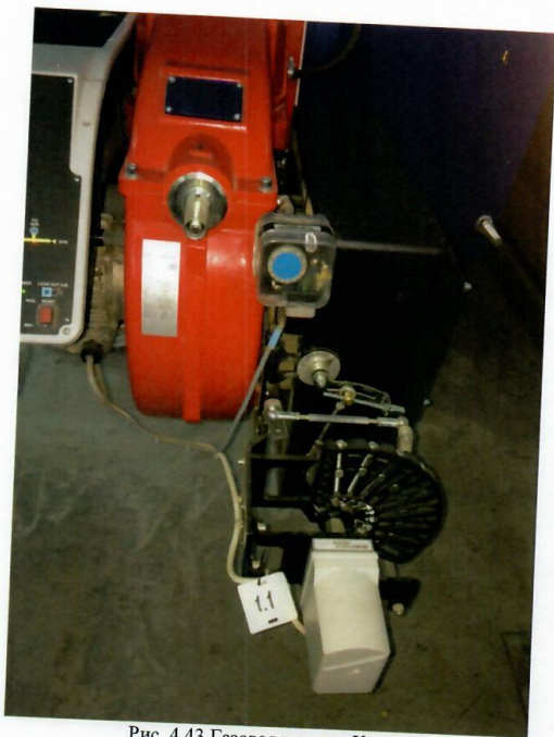
Рис. 4.43 Газовая горелка Котла
