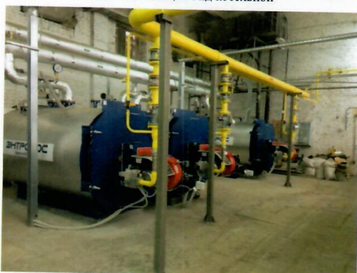
Рис. 4.57 Общий вид котлов (КВ-ГМ-3-115 -3шт)
