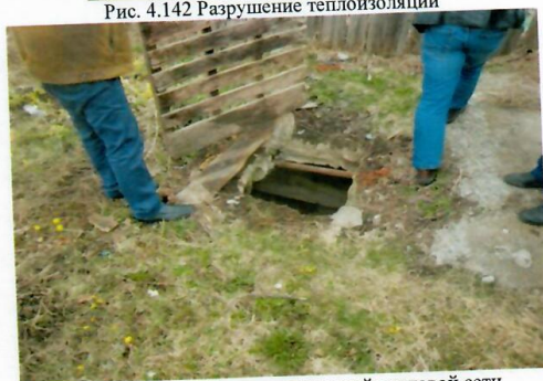
Рис. 4.144 Колодец магистральный тепловой сети
