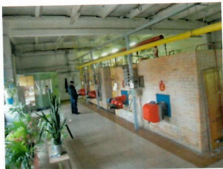
Рис. 4.85 Водогрейные котлы (4 шт.)
