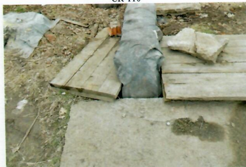
Рис. 4.100 Колодец магистральный тепловой сети
