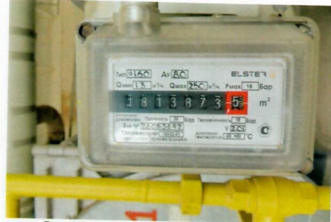
Рис. 4.20 Прибор учета расхода газа котла № 2
