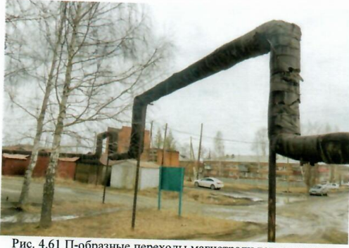
Рис. 4.61 П-образные переходы магистрали теплосети над проезжей частью
