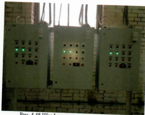
Рис. 4.48 Шкаф управления котлами (3шт)
