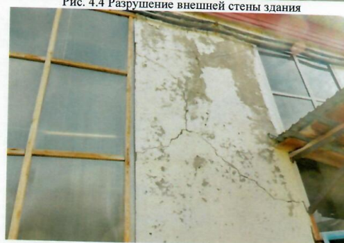
Рис. 4.6 Трещины по стене главного фасада
