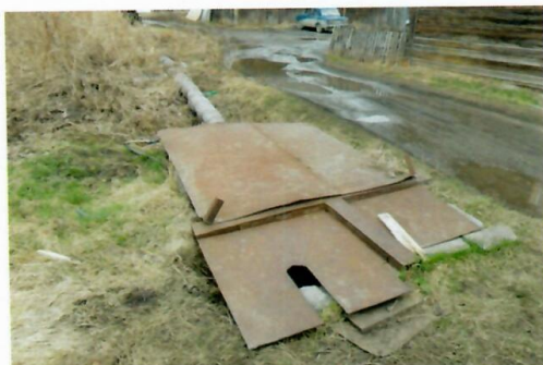
Рис. 4.99 Колодец магистральный тепловой сети
