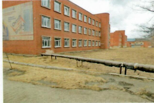
Рис. 4.106 Надземная теплотрасса. Ввод в здание училища
