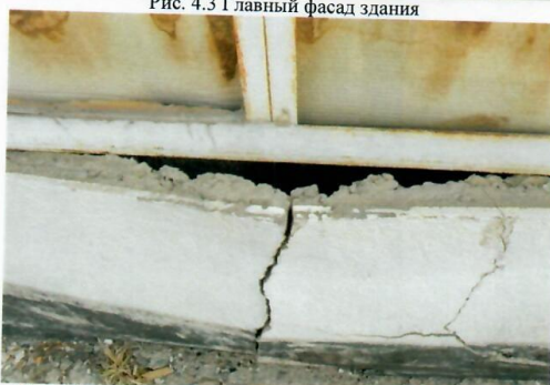
Рис. 4.5 Отслоение внешней части стены оконного проема
