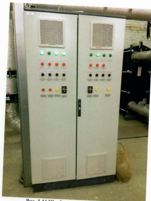
Рис. 4.44 Шкаф управления насосами
