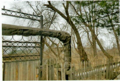
Рис. 4.104 Надземный переход теплотрассы над проездом
