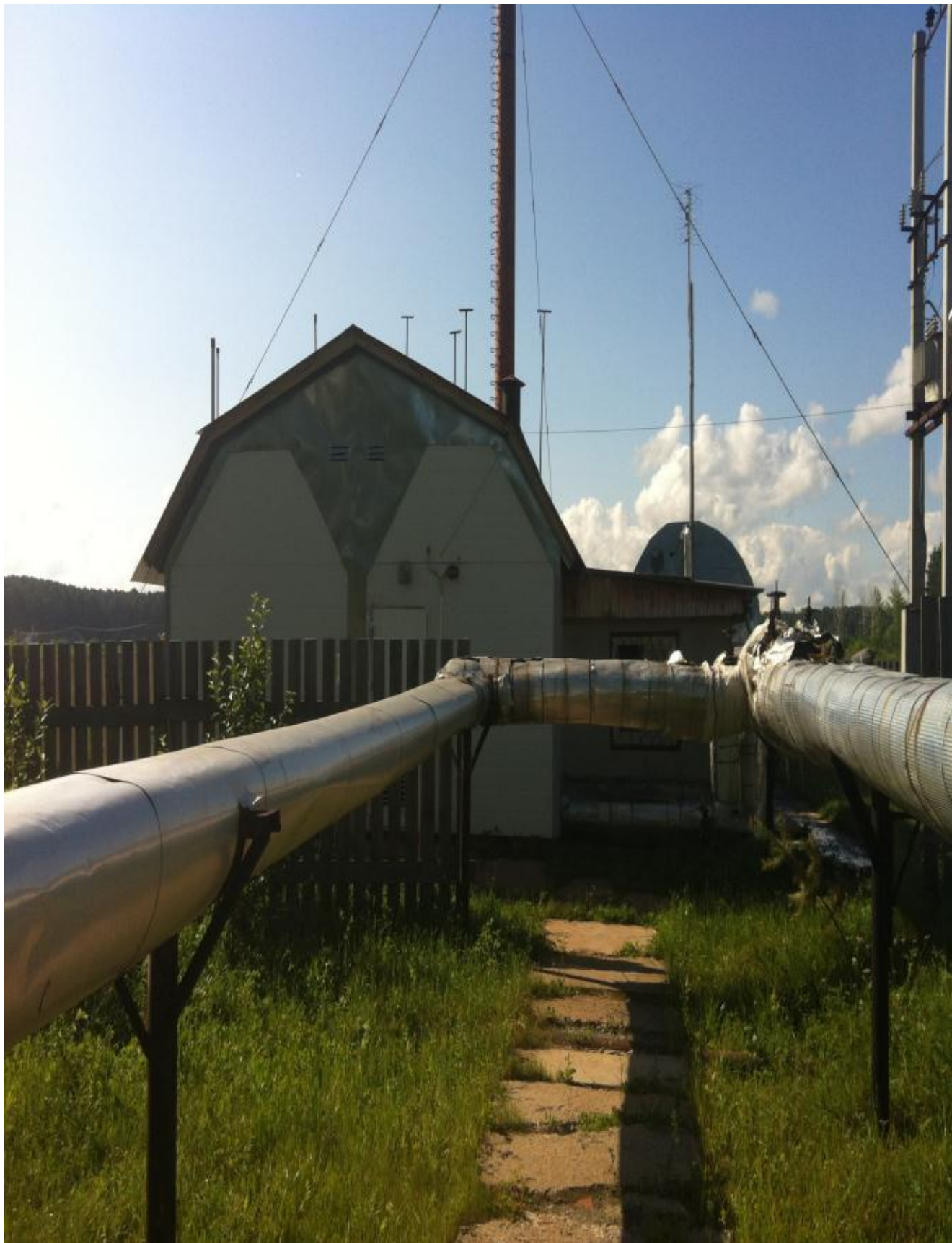
Газовая котельная с. Кашино.
