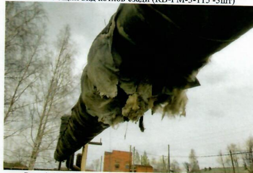
Рис. 4.60 Частичное разрушение теплоизоляции
