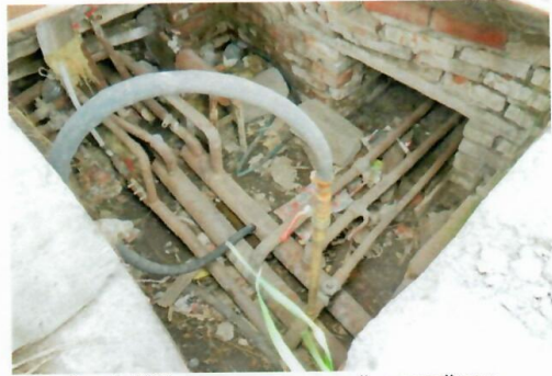
Рис. 4.102 Колодец магистральный тепловой сети
