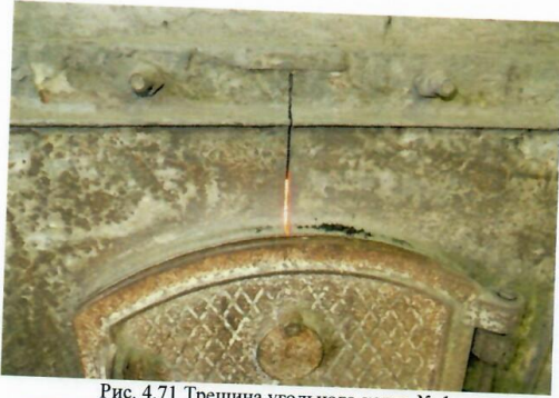
Рис. 4.71 Трещина угольного котла № 1
