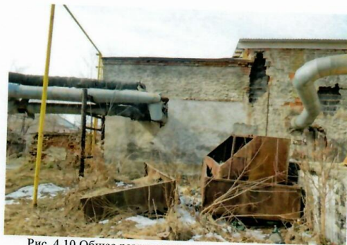
Рис. 4.10 Общее разрушение внешней несущей стены
