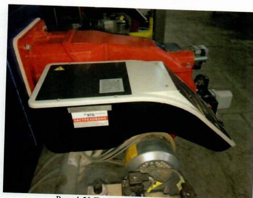
Рис. 4.50 Газовая горелка котла
