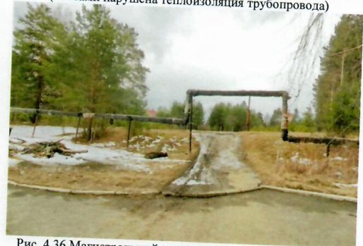
Рис. 4.36 Магистральный компенсатор системы отопления
