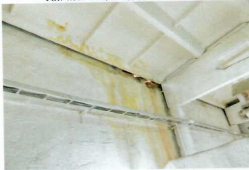
Рис. 4.109 Следы протекания кровли
